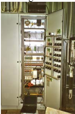
Allan Bradley PLC på vandværket
