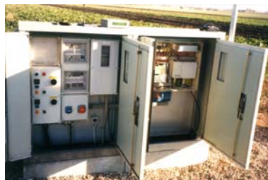
Pumpeskab med radiomodem
