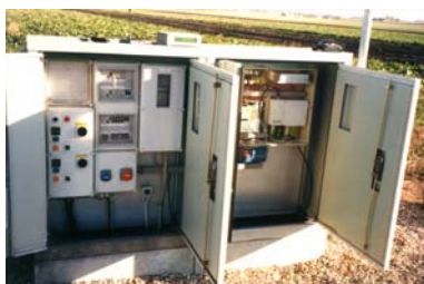
Pumpeskab med radiomodem
