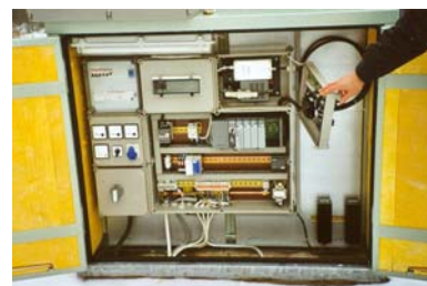
Allan Bradley PLC og radiomodem ved råvandsboring ude i skoven
