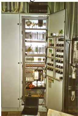
Allan Bradley PLC på vandværket
